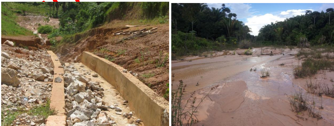
Figura 3 - Valeta de drenagem rompida provocando erosão no pé do talude e assoreamento nas obras da BR-163/PA
