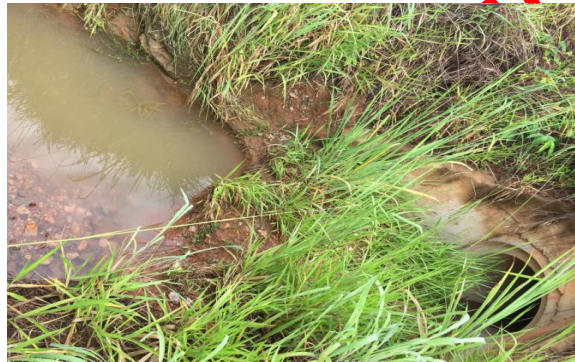
Figura 2 - Bueiro parcialmente entupido Ferrovia Norte-Sul tramo central.
