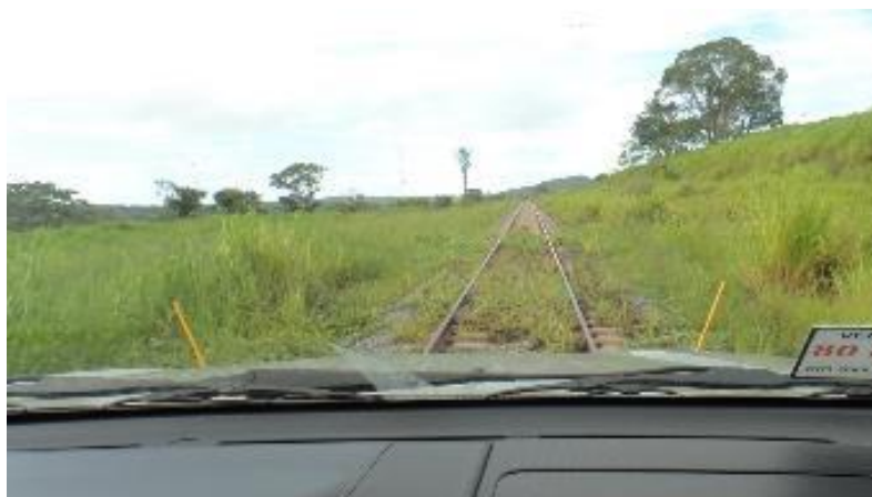
Figura 12 - Trecho necessitando de roçagem (Fonte: Ação de Controle 201700822)
