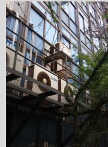
Fig. 8: Equipamentos de Ar Condicionado
