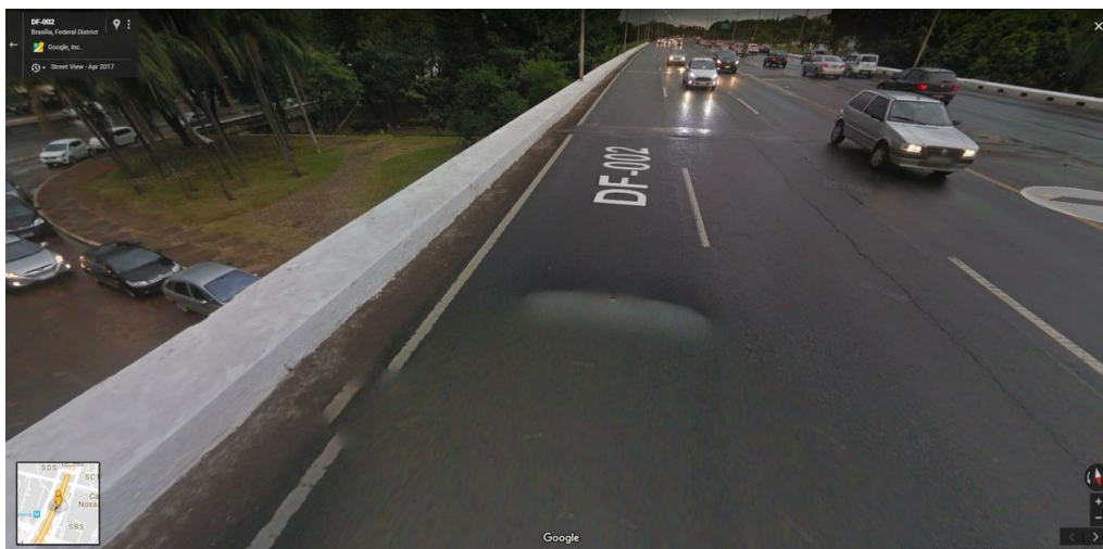
Figura 5.3: Exemplo de rachadura visível em trecho de pista no centro de Brasília/DF.
